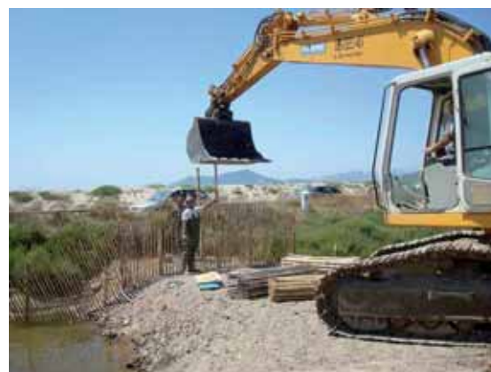
La gestion des batardeaux sur le canal de ceinture ↑
