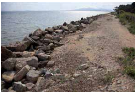
↑ La portion enrochée également touchée
