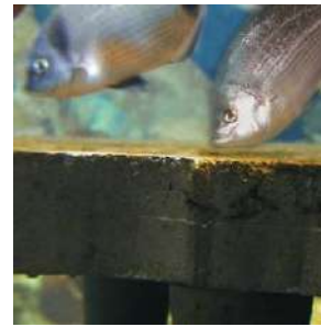
3 – Béton rugueux et décarbonaté
