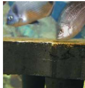
3 – Béton rugueux et décarbonaté
